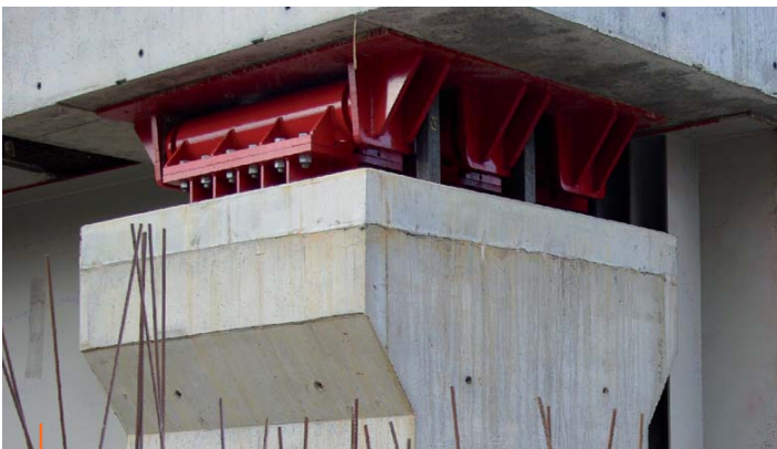
Amortecedores pré-esforçados longitudinais em um contraforte - Viaduto Ferroviário de Epenottes TGV Rhin-Rhône Longitudinal preloaded spring dampers on abutment High speed railroad bridge of Epenottes, France
